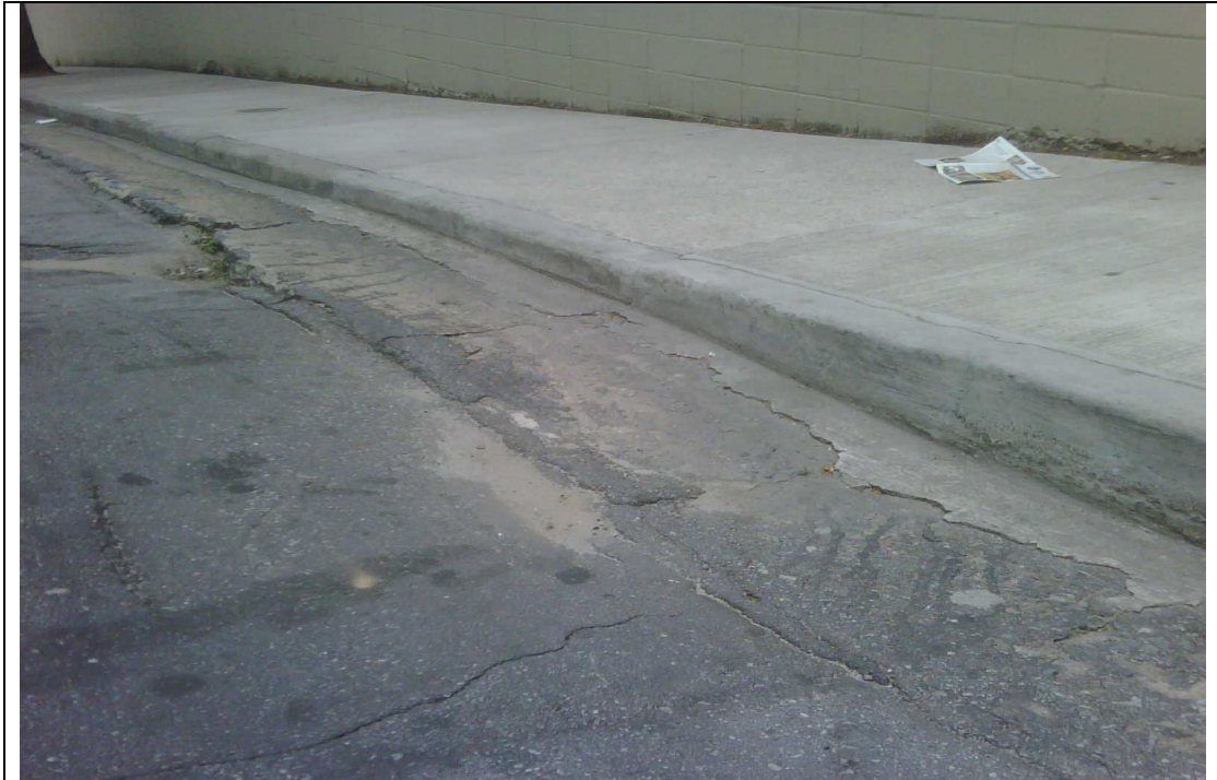
Vista da sarjeta , onde mostra o péssimo serviço executado – Nov/11
